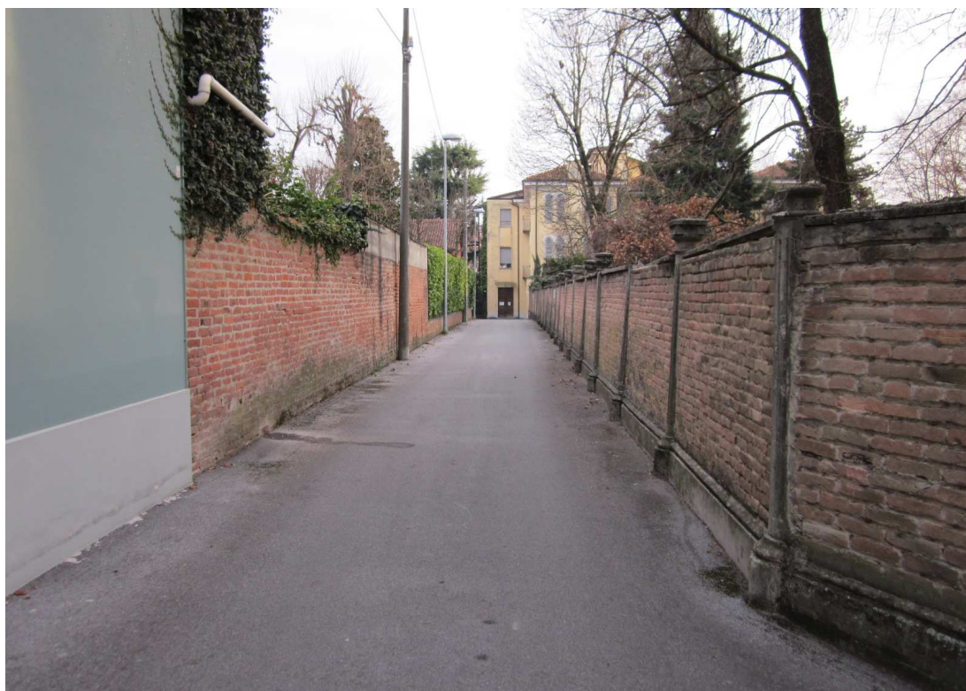
Strada privata esterna di accesso all'edificio, lato est del parco; in primo piano parte del muro di cinta che ha perso la verticalità
